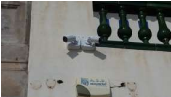
Instal·lació càmeres de seguretat
