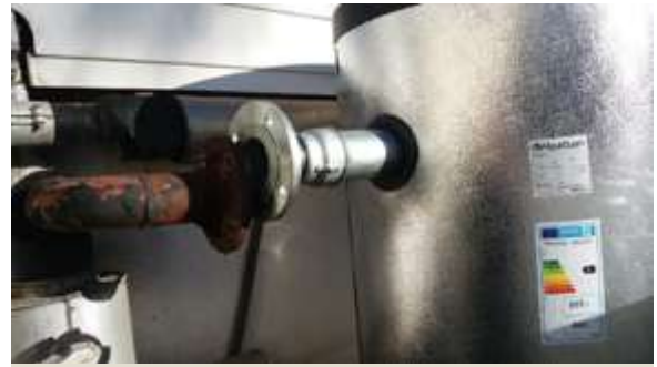
Fuita acumulador pati de màquines
